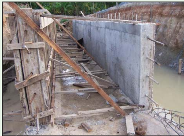
รูปที่ 5-26 เสริมเหล็ก Dowel ให้ตรงตามตำแหน่ง
