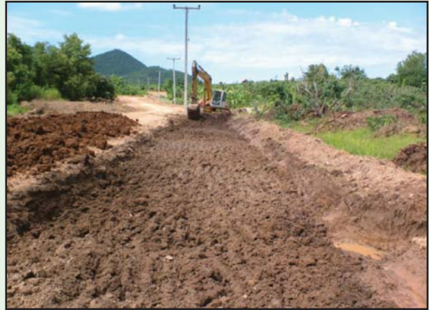
รูปที่ 5-9 ลักษณะดินที่ต้องปรับปรุงก่อนวางท่อ
