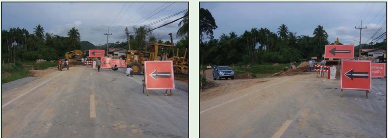
รูปที่ 5-19 แสดงการติดตั้งป้ายเตือนและไฟฟ้แสงสว่างที่บริเวณก่อสร้าง
