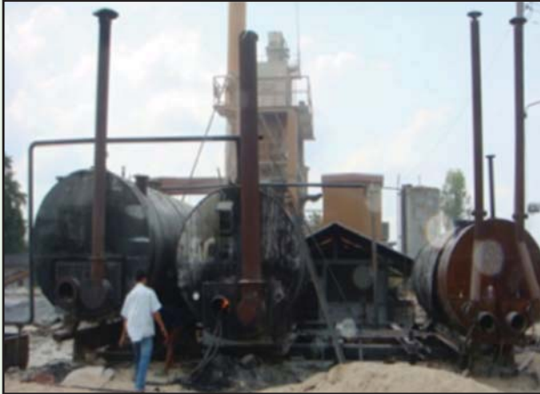
รูปที่ 6-14 ถังเก็บยางแอสฟัลต์
