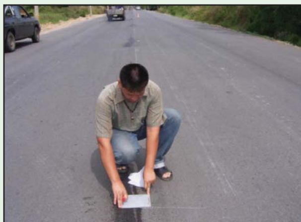
รูปที่ 7-11 แสดงการวางแผ่นเหล็กตามแนวที่จะทาสี
